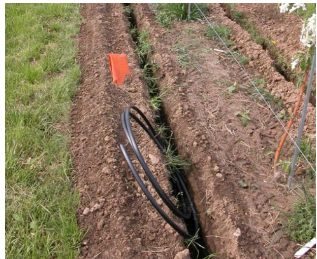
Figure 3-8. Une conduite d'irrigation par goutte-à-goutte est enterrée de chaque côté d'une rangée de jeunes arbres fruitiers.
