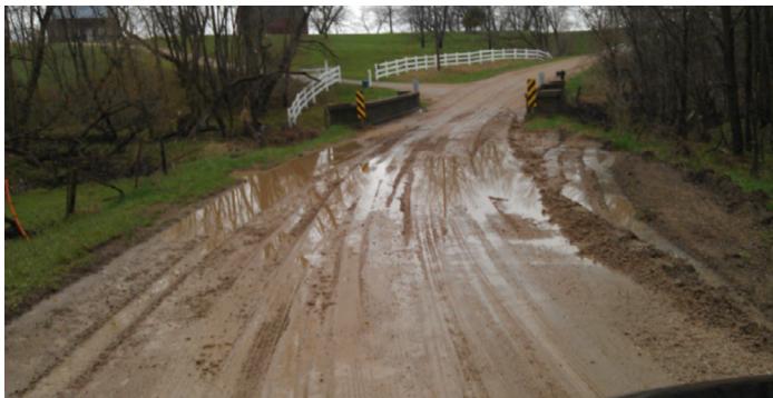
Ornières et surface endommagée d'une route non asphaltée.
