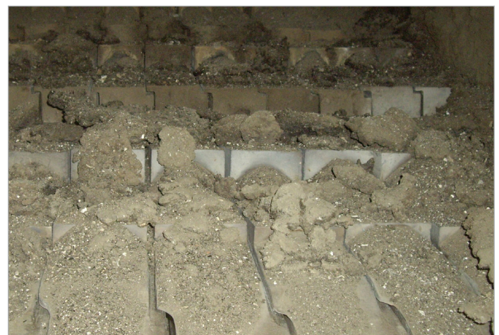
Figure 3. Le mâchefer peut encrasser les éléments de la chaudière. Source : CanmetÉNERGIE.
