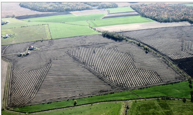
Figure 1. Photo aérienne d'un champ où un réseau de drainage souterrain a récemment été installé.
