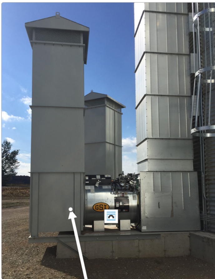
Figure 7. Ventilateur de séchoir muni de silencieux.
