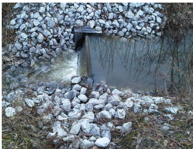
Figure 7-10. Structure de contrôle de l'eau.
