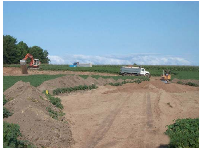
Figure 2–7. Champ de soya endommagé par la construction d'une installation de drainage.
